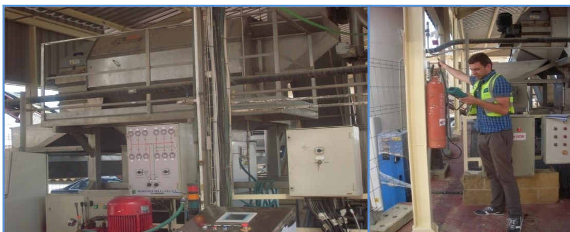
Figura 4. Panel de control del sistema de enfriamiento del mosto y determinaciones de gases GEI en las instalaciones de Bodegas & Viñedos Fontana, D.O. Uclés (Cuenca).
