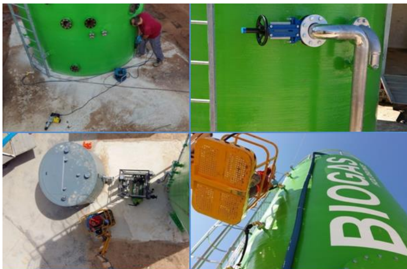
Figura 18. Anclaje de los depósitos, colocación de bridas con espigas y válvula manual en aspiración del digestor, replanteo del grupo de bombeo y colocación de tuberías en altura.
