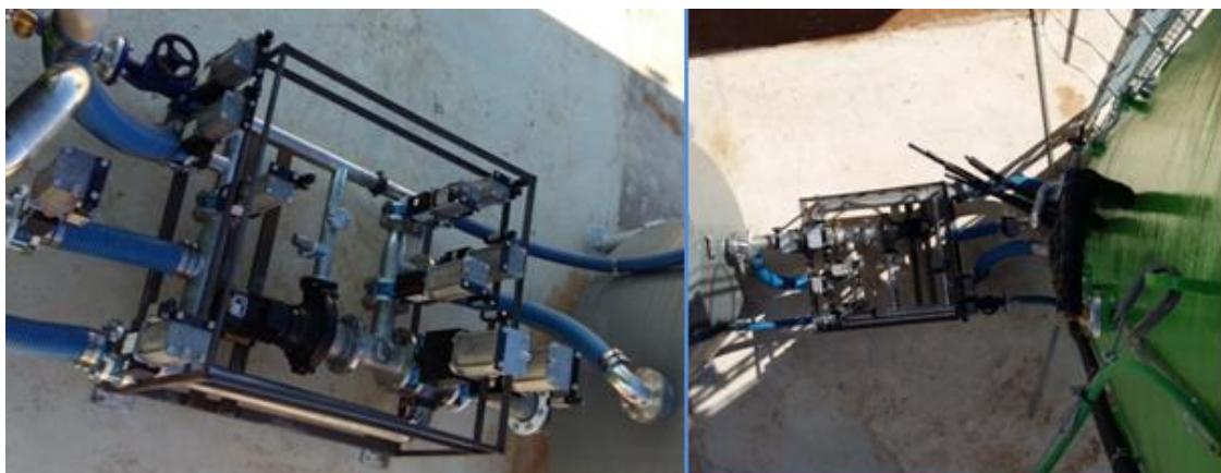
Figura 19. Colocación de las tuberías flexibles de conexionado entre los depósitos y el circuito hidráulico (equipo de bombeo) y de las electroválvulas del pilotaje neumático.
