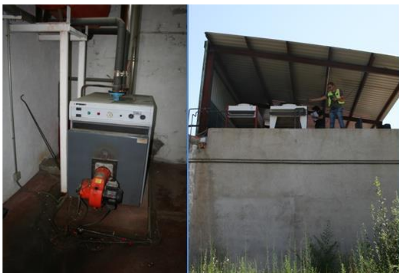
Figura 3. Instalaciones de combustión y medida de emisiones de GEI en las instalaciones de la fábrica de quesos COOLOSAR en el polígono industrial de Losar de la Vera (Cáceres).
